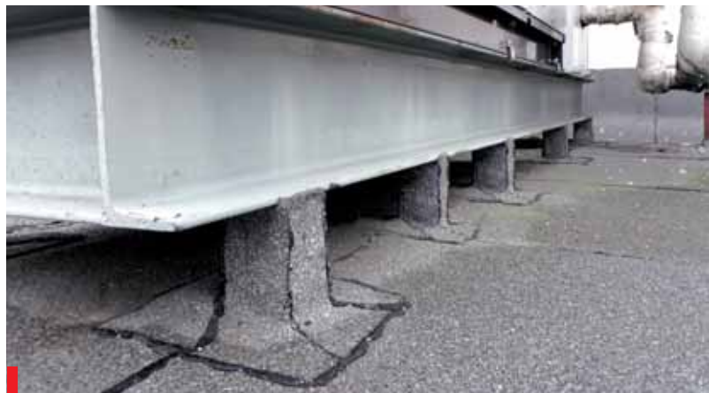
Zbliżenie jednego z detali – wsporniki klimatyzatora
