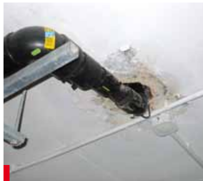
Fot. 10. Systemy odwodnienia podciśnieniowego są nieskuteczne na dachach użytkowych m.in. dlatego, że instalacja szybko zapycha się błotem z nawierzchni komunikacyjnych
