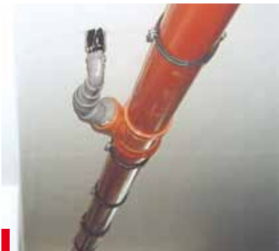
Fot. 9. Wpust podciśnieniowy śr. 56 mm podłączony bezpośrednio do instalacji grawitacyjnej będzie działał grawitacyjnie a nie podciśnieniowo, co znacznie ograniczy spływ wody z dachu (całość wykonano zgodnie z projektem)
