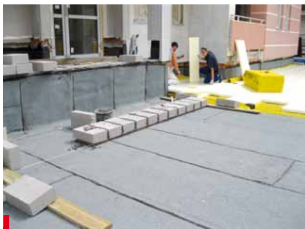
Fot. 6. Rozwiązanie niedopuszczalne
